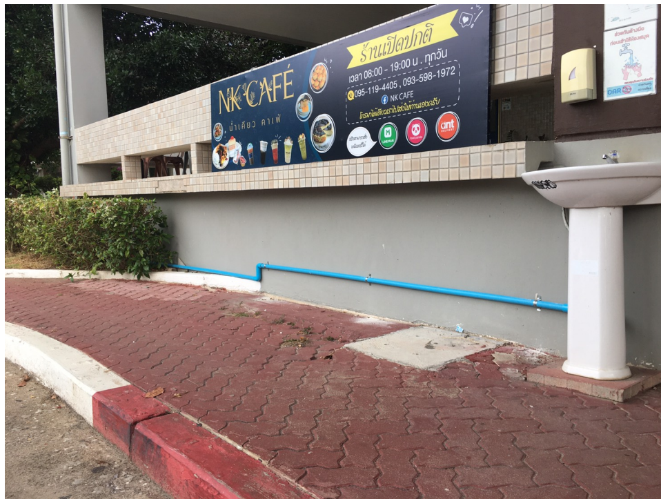
ภาพที่ 3 แสดงการนำน้ำทิ้งจากอ่างล้างมือไปรดน้ำต้นไม้
