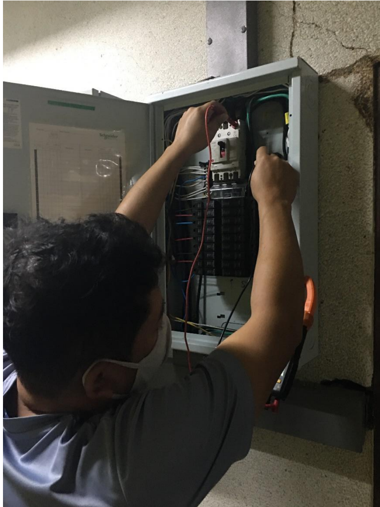
ภาพที่ 9 การตรวจเช็คเมนเซอร์กิตเบรกเกอร์
