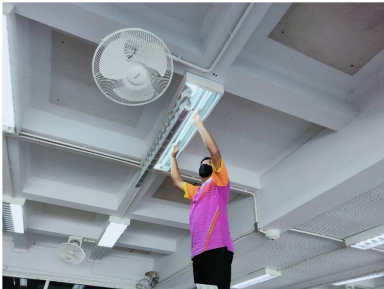
ภาพที่ 10 การตรวจเช็คซ่อมแซมหลอดไฟฟ้าแสงสว่าง
