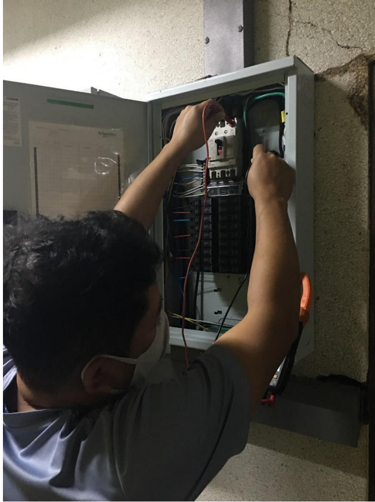
ภาพที่ 9 การตรวจเช็คเมนเซอร์กิตเบรกเกอร์
